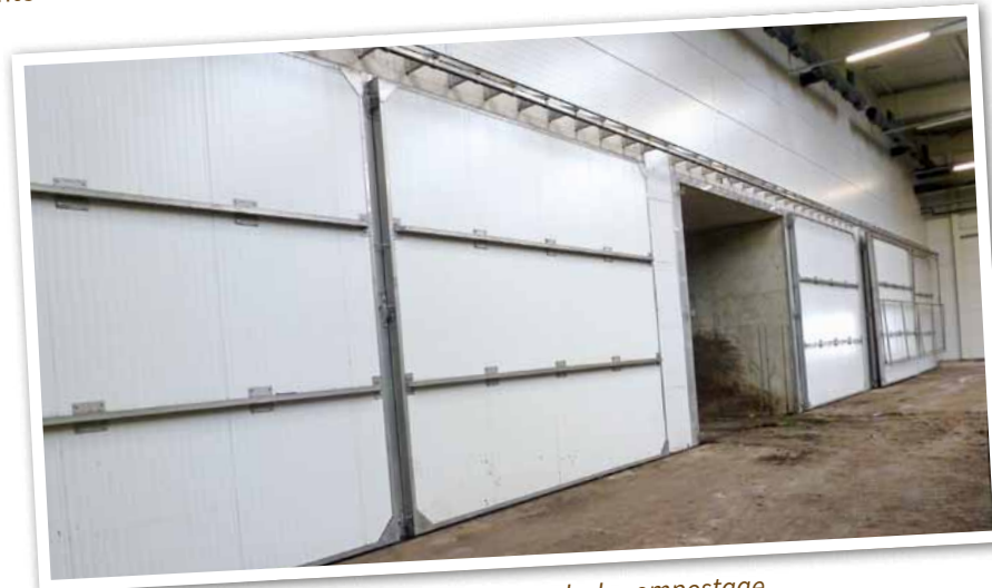
Die Rottetunnel · Tunnels de compostage
