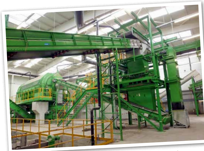
Mechanische Aufbereitung · Filière de préparation
